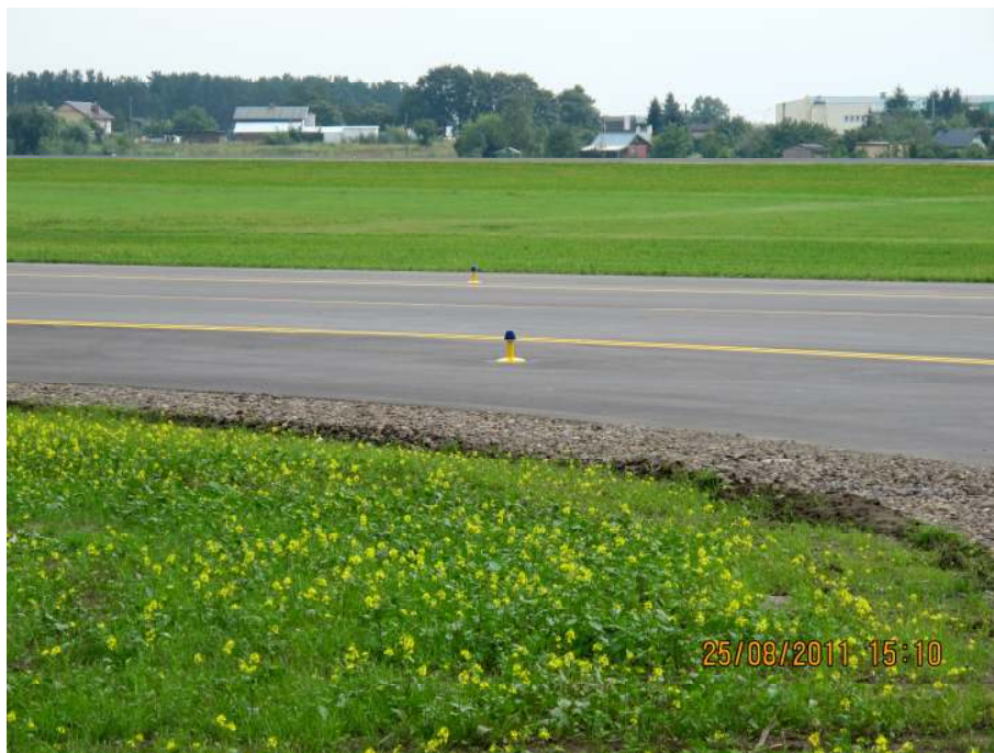
Lampy krawędziowa drogi kołowania
