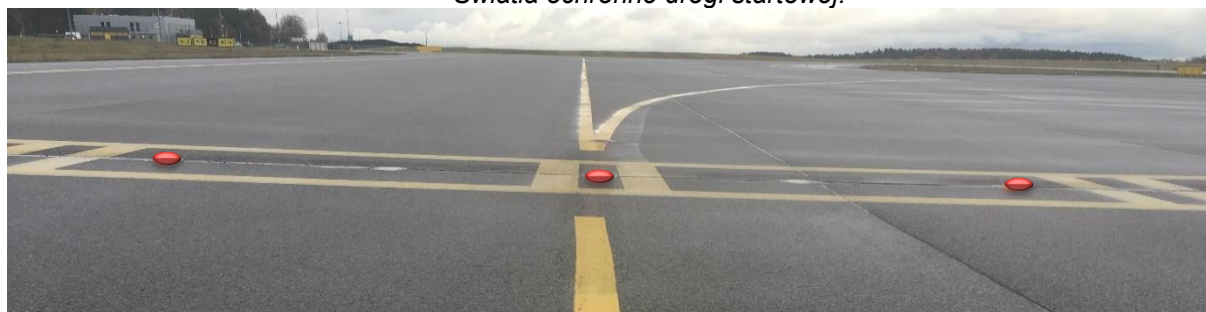
Oświetlenie miejsca oczekiwania przed drogą startową.
